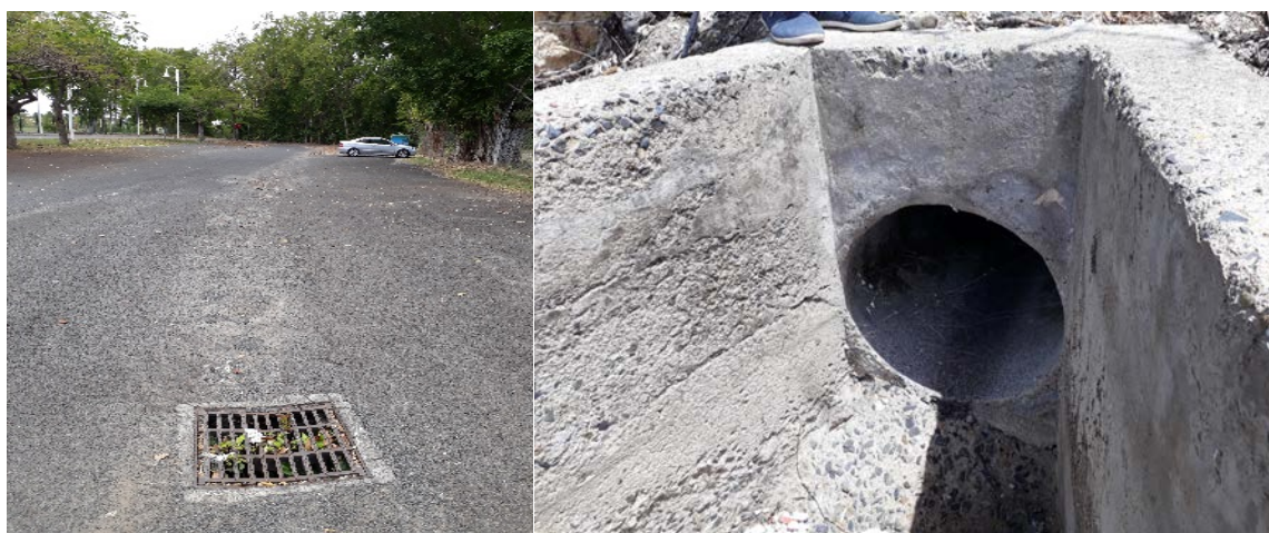
Figure 7 : Infrastructures existantes de collecte des eaux pluviales (Ouest)
