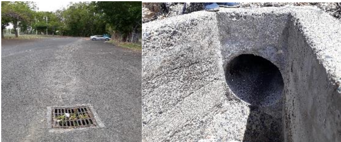
Figure 89 : infrastructures existantes de collecte des eaux pluviales (ouest)
